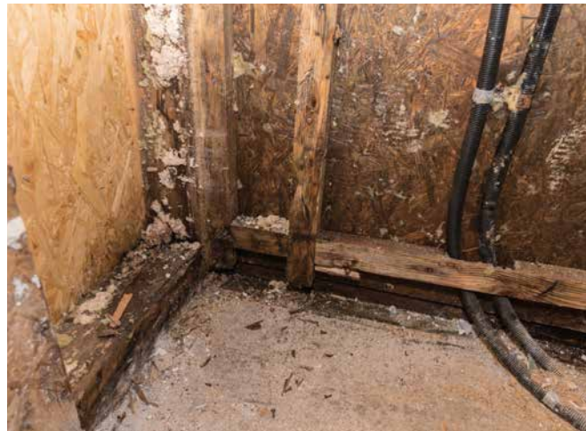
Durch Feuchtmessung lässt sich das ganze Ausmaß der Schäden ermitteln
